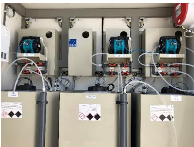
Abb. Dosierstation Chemikalien
