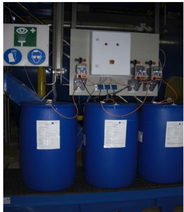
Abbildung 11: Dosierstation für Chemikalien
