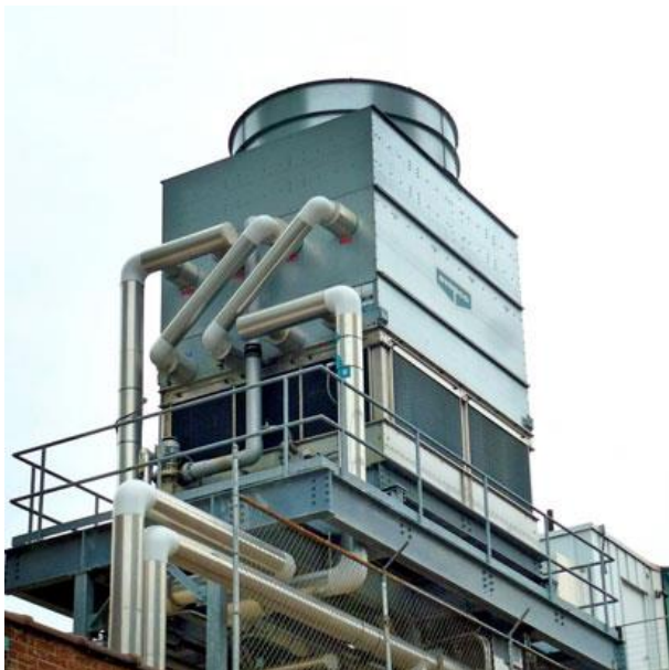
Abbildung 2: Verdunstungskühlanlage (VDKA) als Beispiel für einen offenen Kühlkreislauf
