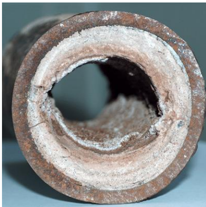
Abbildung 7: Rohrstück, das sehr viele Kalkablagerungen aufweist durch Kalk im Kühlwasser
