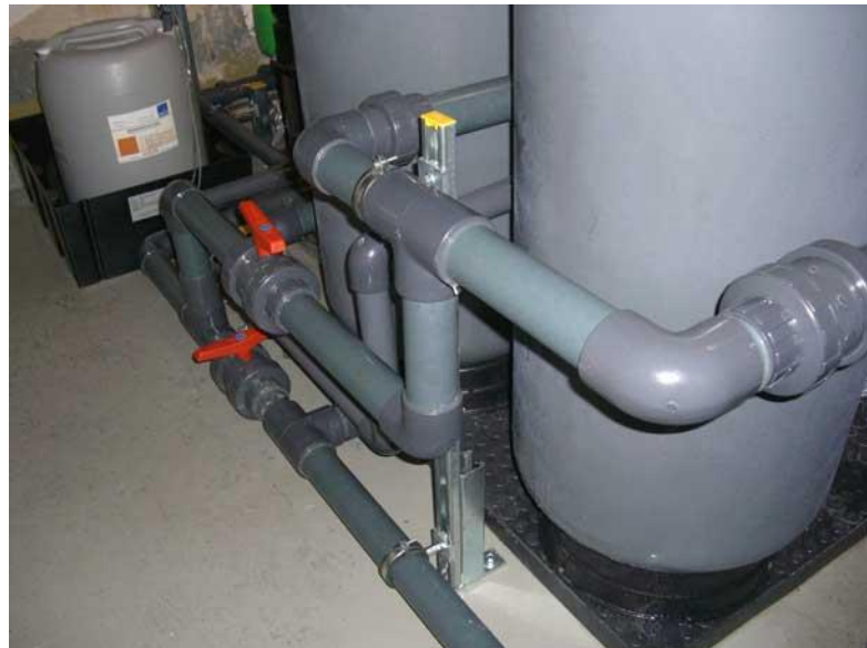
Abbildung 17: Verrohrung eines Aktivkohlefilters mit BIRM Filtermaterial
