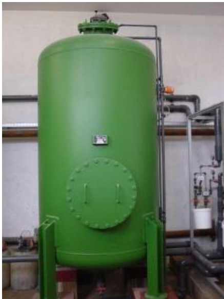
Abbildung 16: Aktivkohlefilter für Rohwasser 15 m 3 /h
