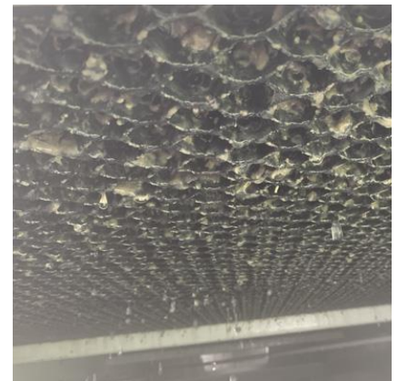
Abbildung 9: Füllkörper- bzw. Kühlturmeinbauten mit Biofilm und Ablagerungen
