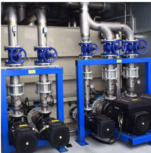
Abbildung 4: Pumpstation mit Verbraucher- und Kühlturmpumpen eines Kühlturms
