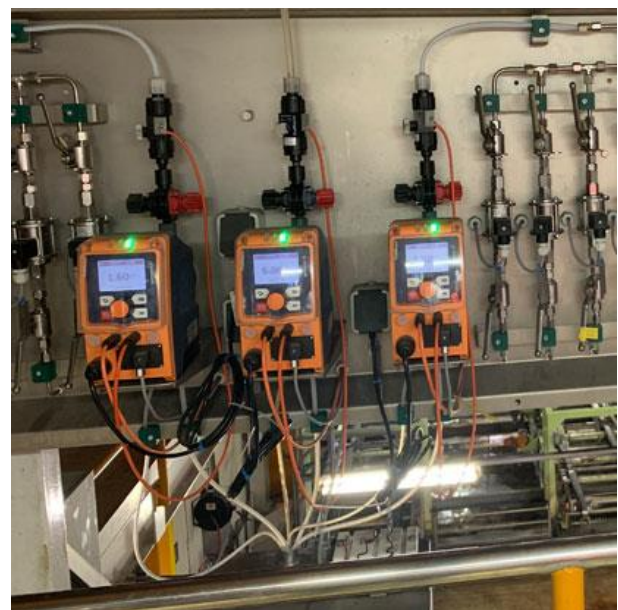
Abbildung 5: Dosierstation mit gammaX-Pumpen
