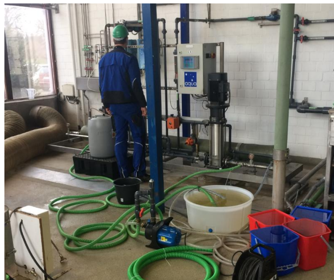
Abbildung 19: Reinigung und Wartung einer UO-Anlage
