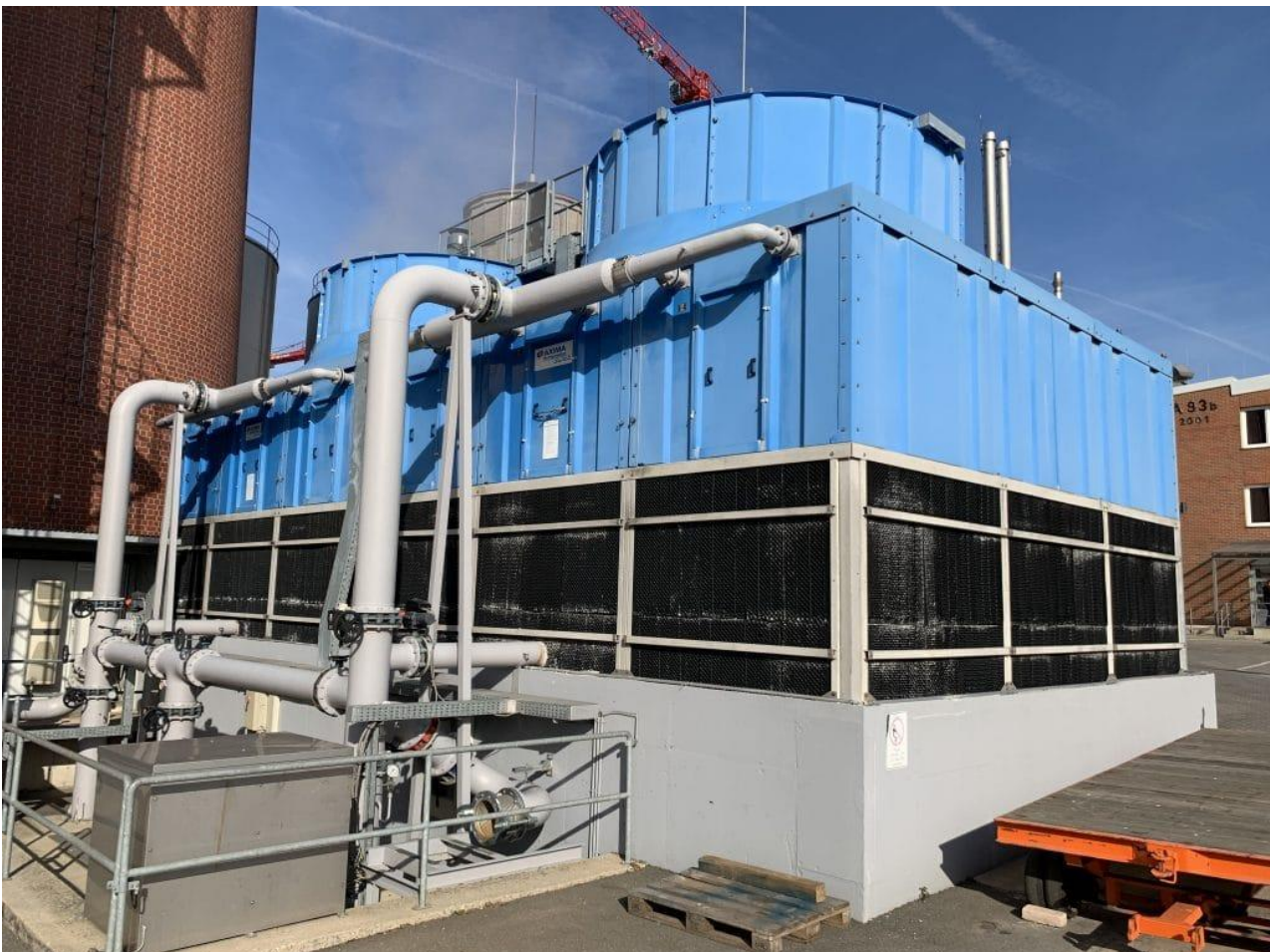
Abbildung 255: Verdunstungskühlanlage („Kühlturm“) eines Kunden in der Industrie
