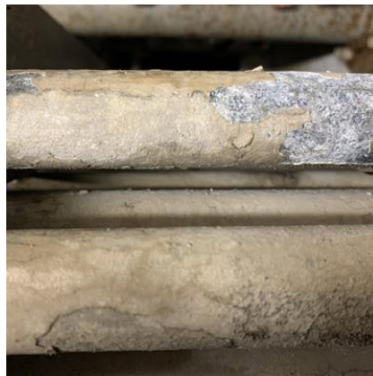
Abbildung 8: Kalkablagerungen am Rohrbündelwärmetauscher eines Kühlturms
