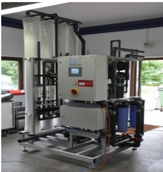
Abbildung 18: UO Anlage 8 m 3 /h mit EH Ventilautomatik
