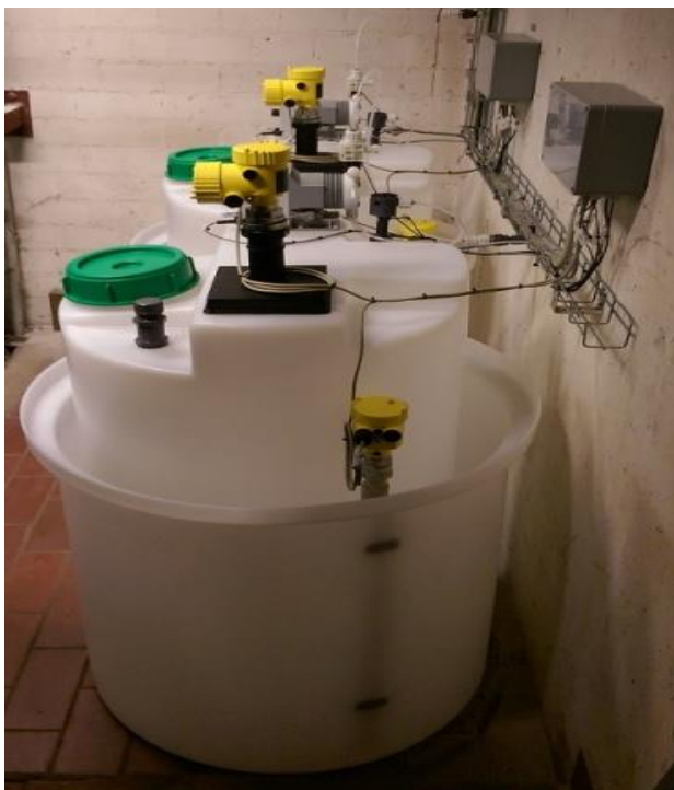
Abbildung 10: Dosieranlage für Chemikalien
