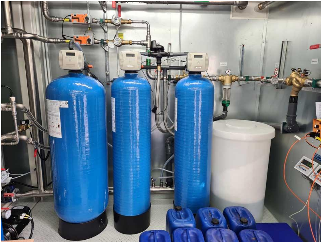
Abbildung 22: Doppel-Enthärtungsanlage (rechts) und Einzelkiesfilter (links) bei einem Kunden im Container verbaut
